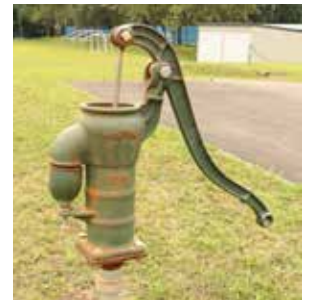
▲新得中学校に設置された地下水ポンプ
