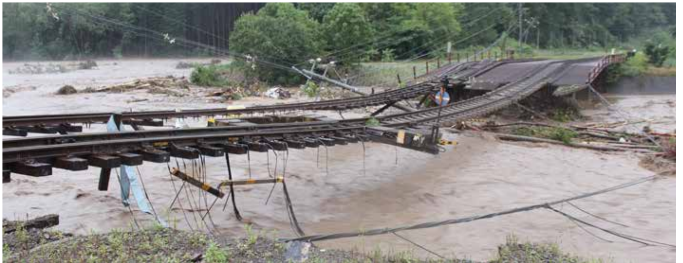
▼ 崩落した、パンケシントク川にかかるJR線路鉄橋 (8月31日午前5時撮影 本通橋西側)
