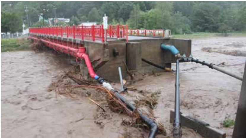
◀ 崩落した神社橋 (8月31日午前5時撮影)
