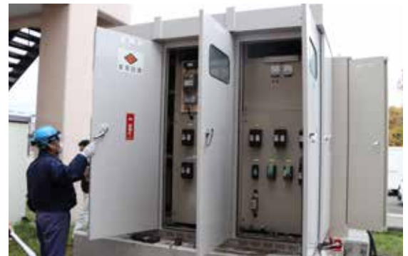
▲屈足総合会館に整備された接続盤
