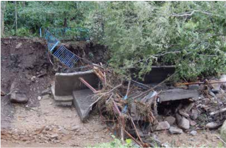
▼被災後の取水施設。河川の氾濫により原型を留めないほどに崩壊した。ここから新得山にある浄水場へ数kmに渡って水を引く導水管も激しく損傷した（8月31日撮影）
