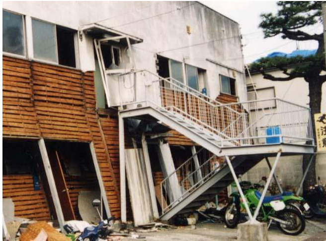
屋外階段の傾斜被害(Cランク)
