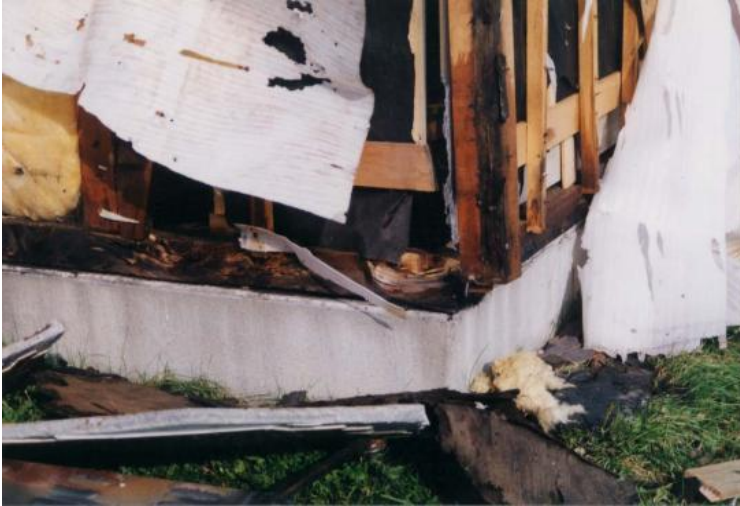
土台、柱の腐朽(Cランク)
