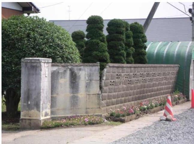
ブロック塀の転倒危険(Cランク)
