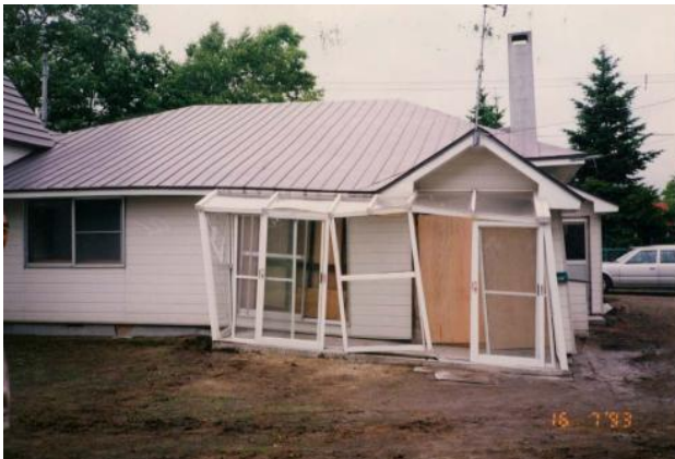
建物の不同沈下(Cランク)
