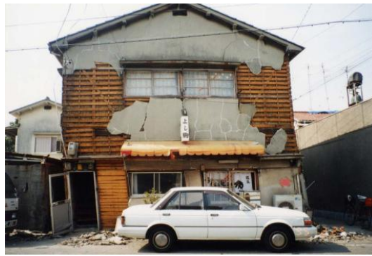
外壁の被害(Cランク)
