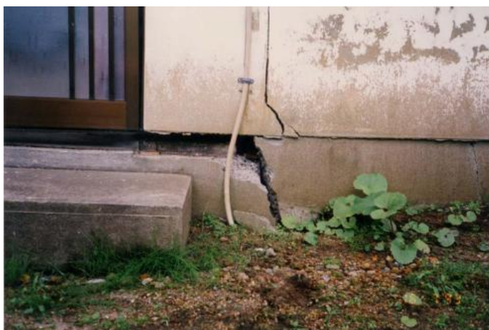
基礎の破断:Cランク
