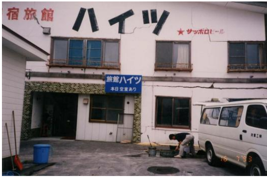
外壁の被害(Bランク)
