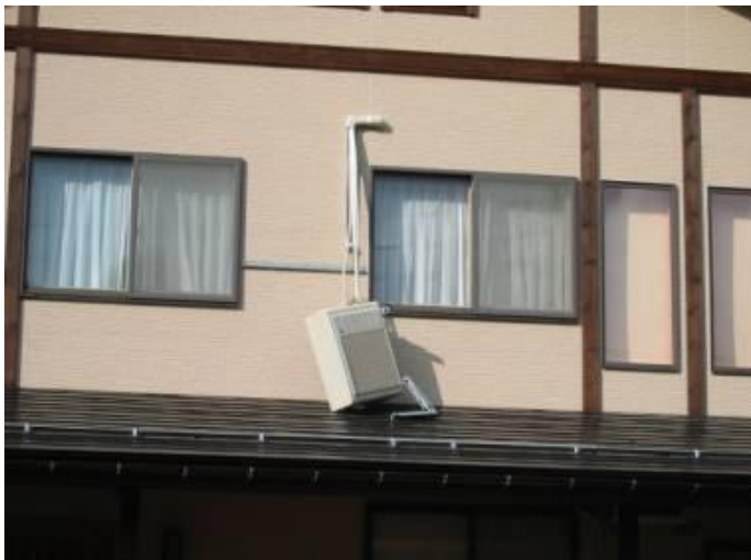
エアコン室外機の落下危険(Cランク)
